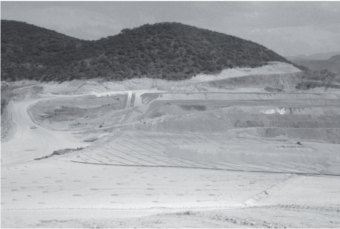
Presa de lixibidación para extracción del mineral
